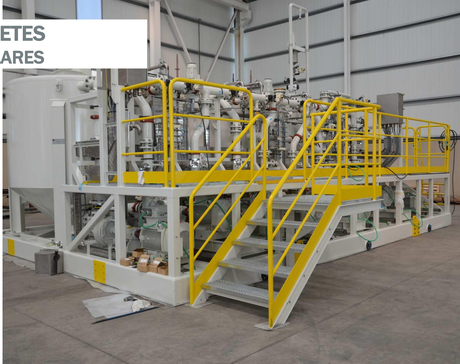
Fotografía: Módulo de reinyección de cuttings durante pruebas de funcionamiento.
