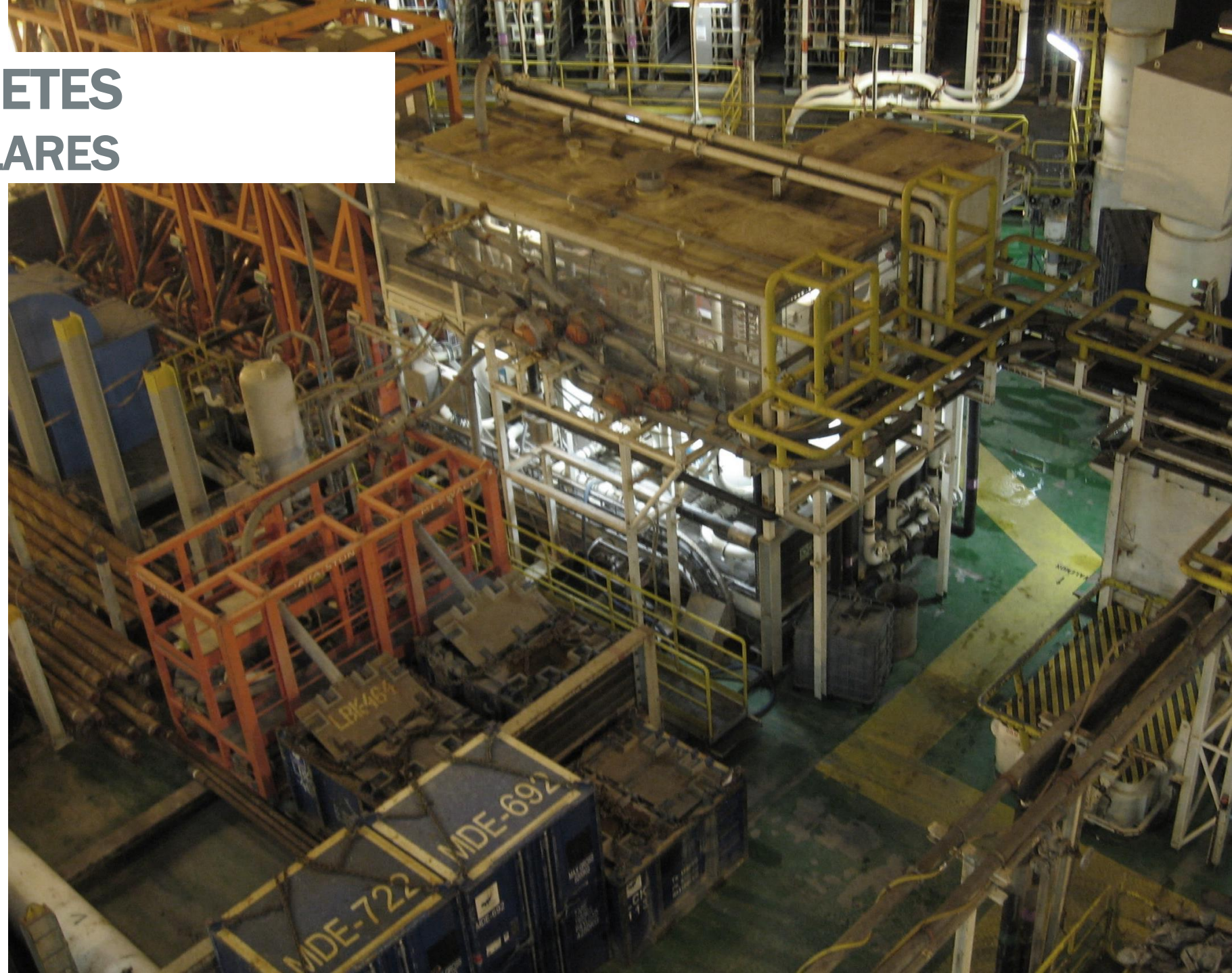
Fotografía: Módulo de reinyección de cuttings en servicio sobre cubierta de plataforma West Elara.
